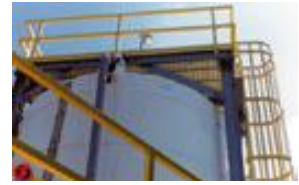
储罐、光栅和栏杆系统
