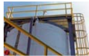
油罐、光栅和栏杆系统
