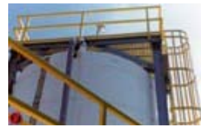
油罐、光栅和栏杆系统
